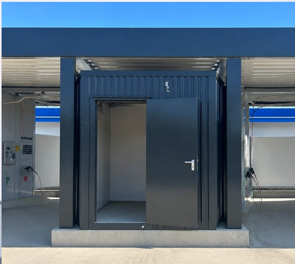
Container Integriert in eine Light-Stahlbau Anlage
